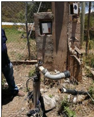
Bomba de agua sin funcionamiento.
