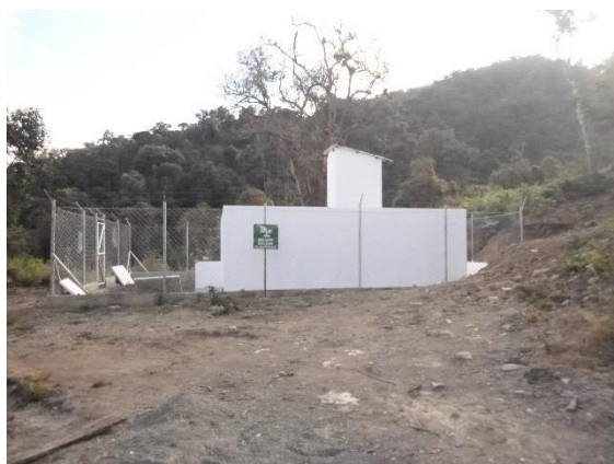
Tanque de Almacenamiento en proyecto "CONST. SIST. AGUA POTABLE CORANI PAMPA D-6 (COLOMI)" - Cochabamba
