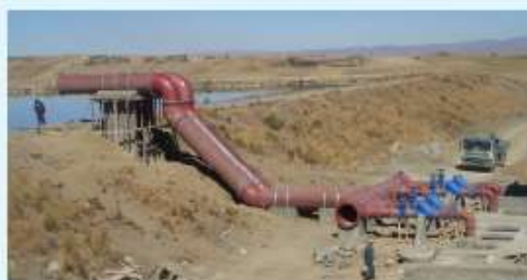
Planta de Tratamiento de Aguas Residuales Puchukollo en El Alto
