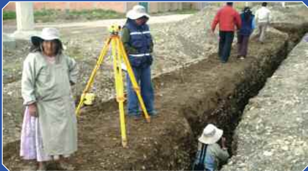
Zona San Roque, Distrito 7. Se hacen las pruebas hidráulicas del sistema de alcantarillado sanitario que ya concluyó.
