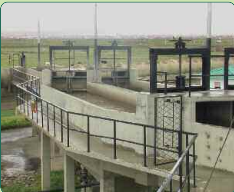
Ésta es la Planta de Tratamiento de Aguas Residuales de Puchuckollo, en actual ampliación. En el corto plazo se iniciarán las obras de construcción de una segunda planta en la zona de Tacachira, Distrito 7 de la ciudad de El Alto.
