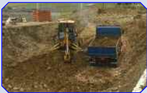
Una máquina excava el lugar donde se construirá la estación de recirculación.
