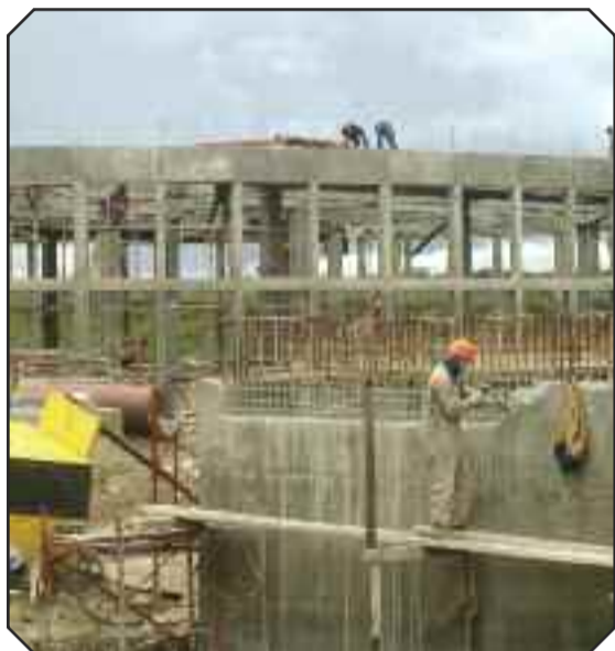
Uno de los filtros percoladores que será recubierto con calamina galvanizada. En la parte superior instalarán los rociadores de agua.
