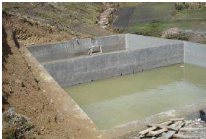
Un estanque de agua para el sistema de riego en Acoraimes, Departamento de La Paz. La obra ha sido construida con recursos de emergencia del Tesoro General de la Nación (Foto DNR).
