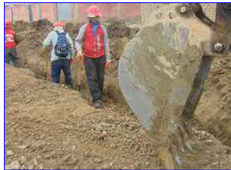
La red de alcantarillado que se conectará a la Planta Tacachira está en plena ejecución. La foto muestra los trabajos que se realizan en el Distrito Municipal N° 7 de El Alto. (Foto arch.)
